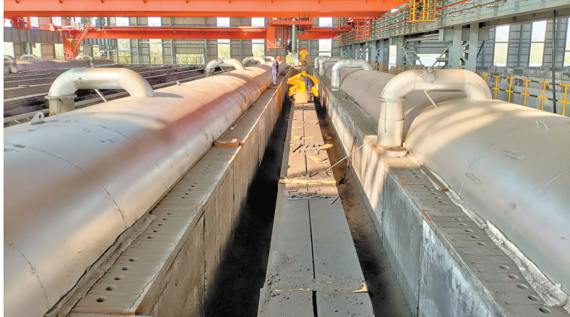
三晋碳素新材料有限公司生产线
