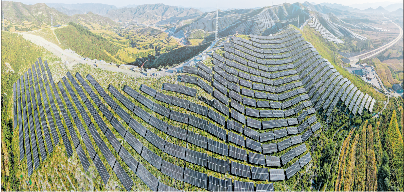
中国能建晋中昔阳100MW光伏发电项目
