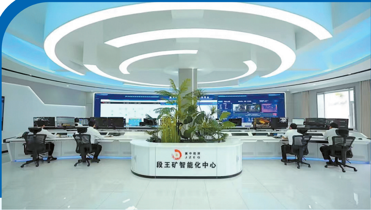
段王煤矿数字平台
