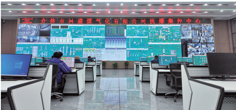
昌盛煤气化有限公司集控中心。 雷浩 摄
