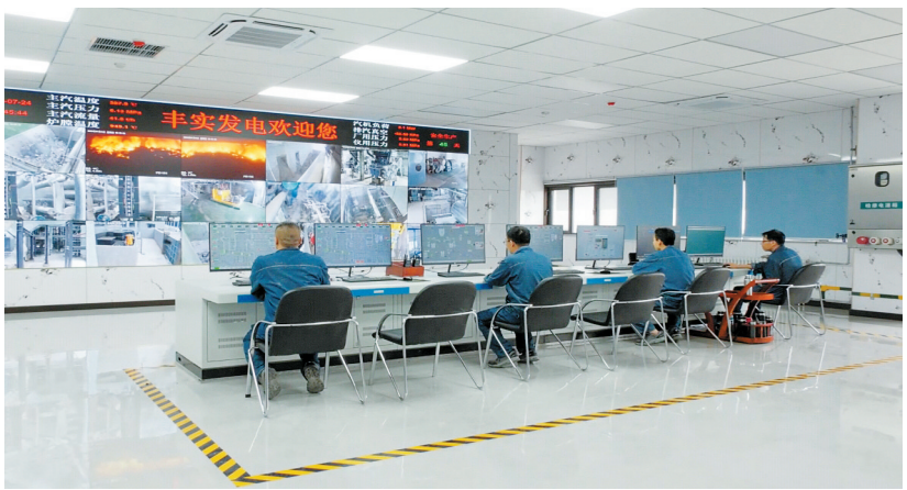
平遥丰实再生资源回收开发有限公司中控室
