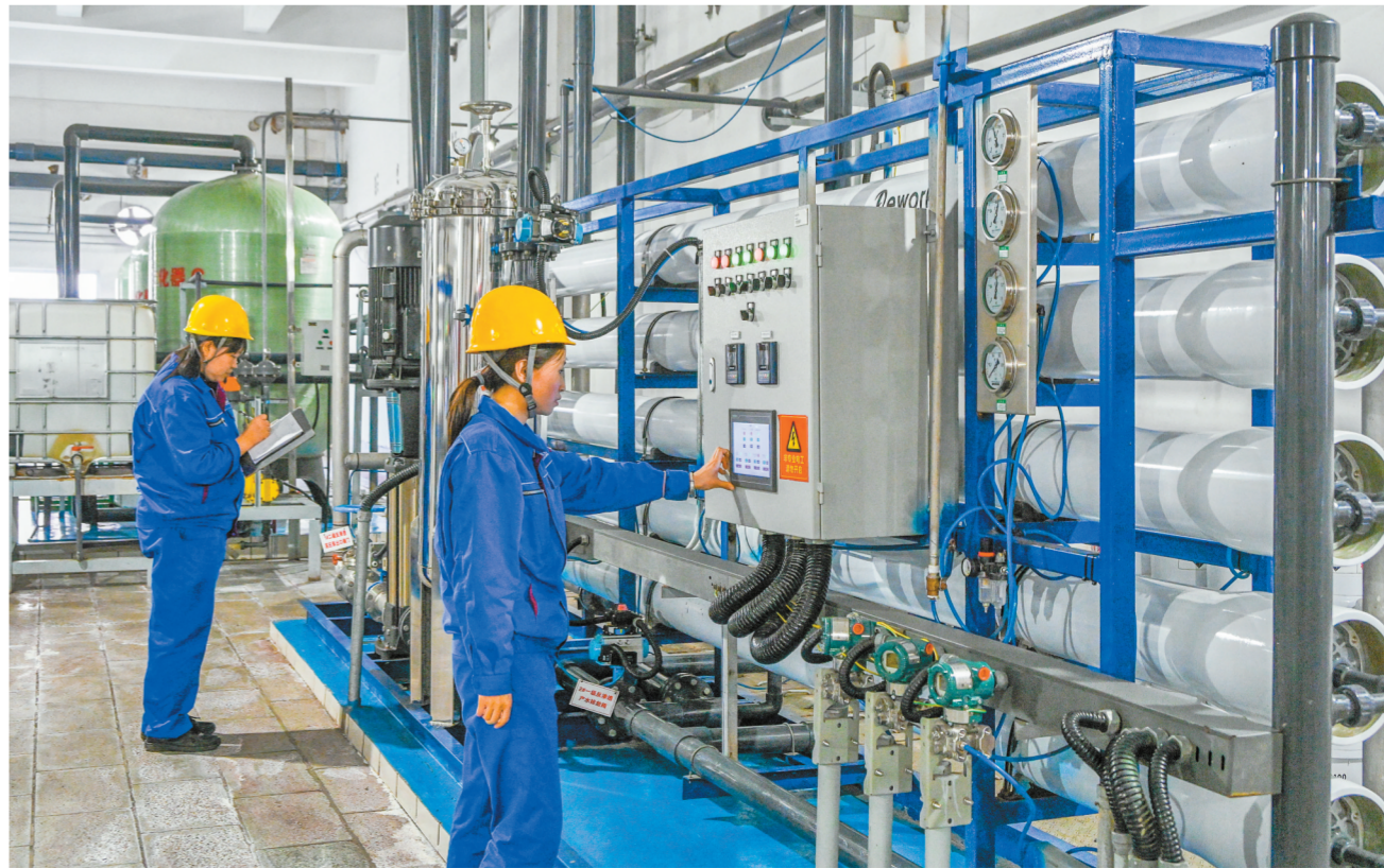
12月9日,技术人员在平遥煤化(集团)有限责任公司6.25米捣固型焦化改造升级项目除盐水站车间监控设备运行情况。 本报通讯员 梁生仁 摄
