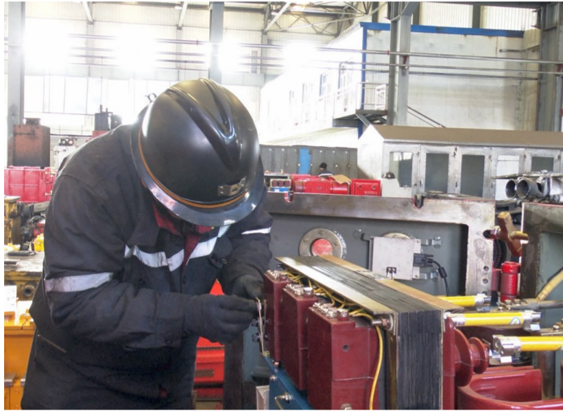
工人正在检修水泵房的高压软启动开关。 王玮 摄
