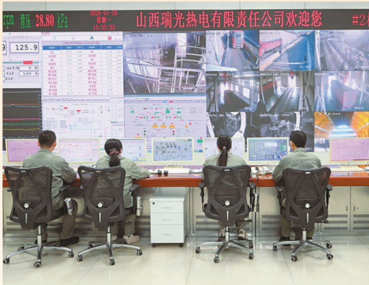
集控值班员在控制室进行机组运行监控。
