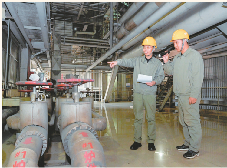
工作人员对运行设备进行日常巡检。
