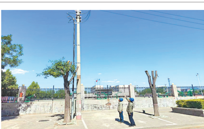
连日来,为全力保障高考期间辖区各考点电力设备安全,国网平遥县供电公司工作人员对辖区涉考供电线路、配电设备开展全方位、地毯式专项巡视排查。
