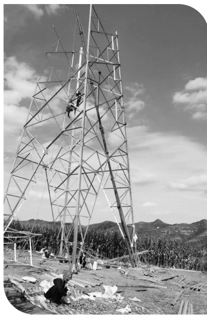
和顺县吕鑫露采矿100MW光伏项目 记者 程婧 摄
