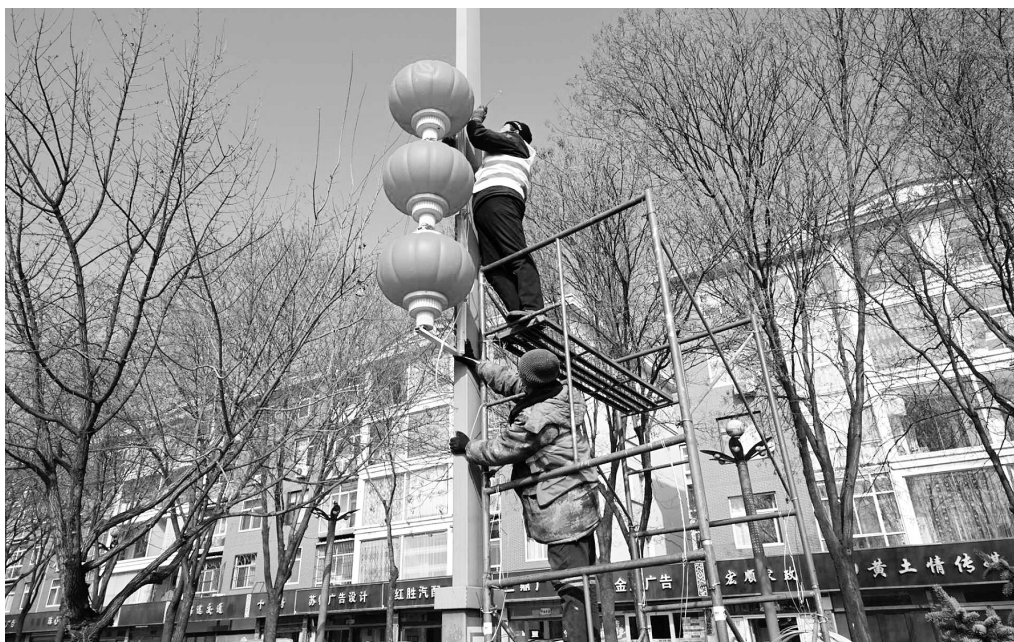
1月31日，左权县市政景观照明施工人员在县城滨河路、北大街、辽山路等街道两侧挂起了红灯笼，喜迎新春佳节。
